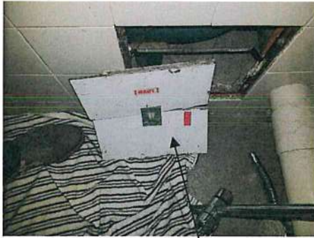
Support de la trappe de visite en amiante ciment.
